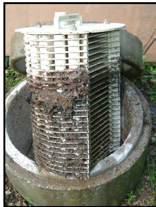
A dirty EFFLUENT screen.
